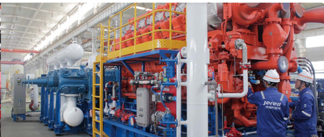
杰瑞在设备成撬方面，成为国内首屈一指的压缩机成撬商
