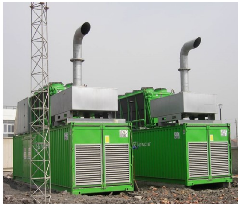
2 × 1416kw瓦斯发电站 2 × 1416kw gas power generation
